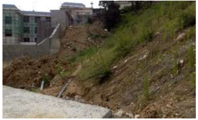
县人民医院现有医疗废水入污水处理站管网
