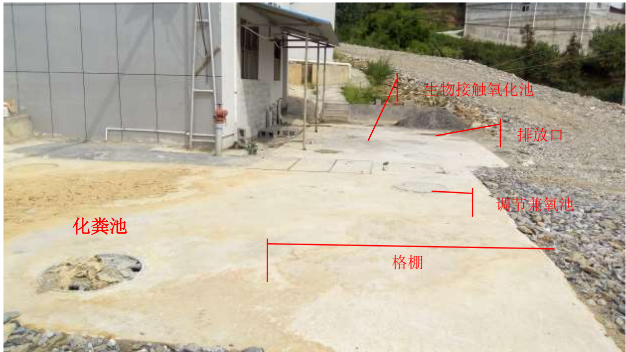
污水处理站主要构筑物分布情况
