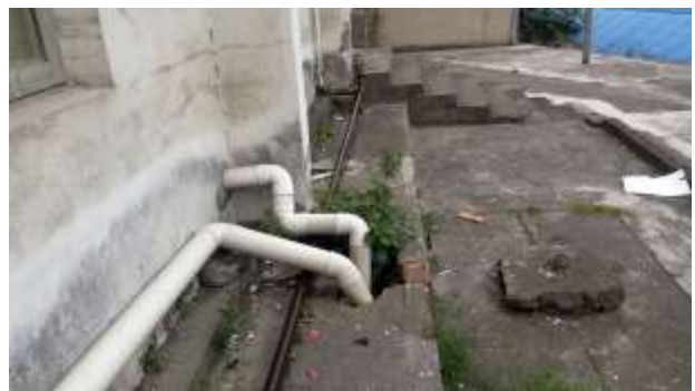
县人民医院医疗区医疗废水收集管网
