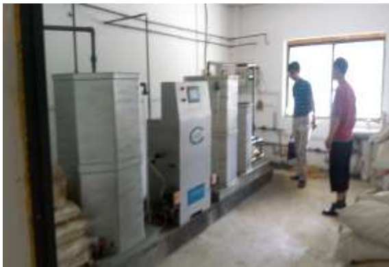
污水处理站配套的二氧化氯发生器
