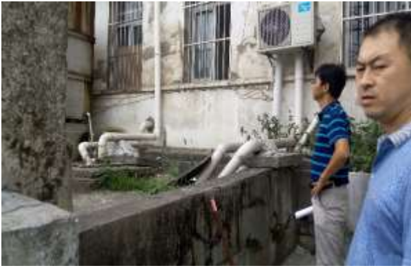
县人民医院医疗废水收集管网及 1#化粪池
